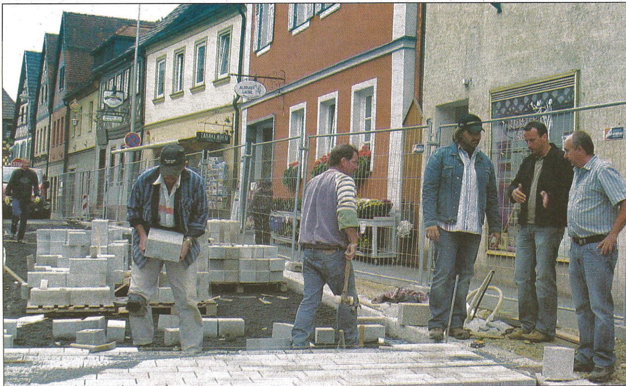
In der Bahnhofstraße beginnen die Pflasterarbeiten. Der ausführende Planer Manuel Kellner und Stadtbaumeister Andreas Ender besprechen das weitere Vorgehen. Foto: rö
